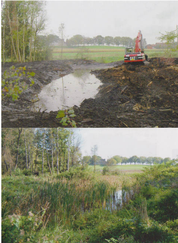
Abbildung 4: Oben die Entfernung von standortsfremden Fichten und unten die daraus neu entstandenen Feuchtstandorte im "Moorwald" (Hafner & Rieder, Renaturierungsmassnahmen in den Jahren 2002 bis 2007, 2010).
